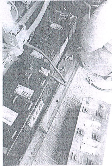
Fig. 4 – Reemplazo de terminales
